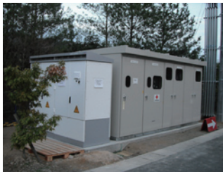
岡山第二工場に設置した太陽光高圧キュービクル・パワコンディショナー
