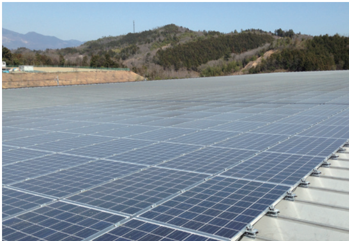
岡山第二工場の屋上に設置した太陽光パネル
