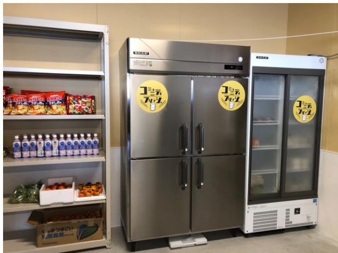
設置された弊社冷蔵庫
