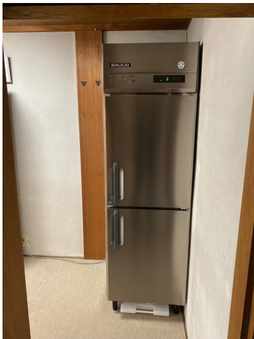
設置したタテ型冷蔵庫
