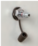
ガスホース接続口
